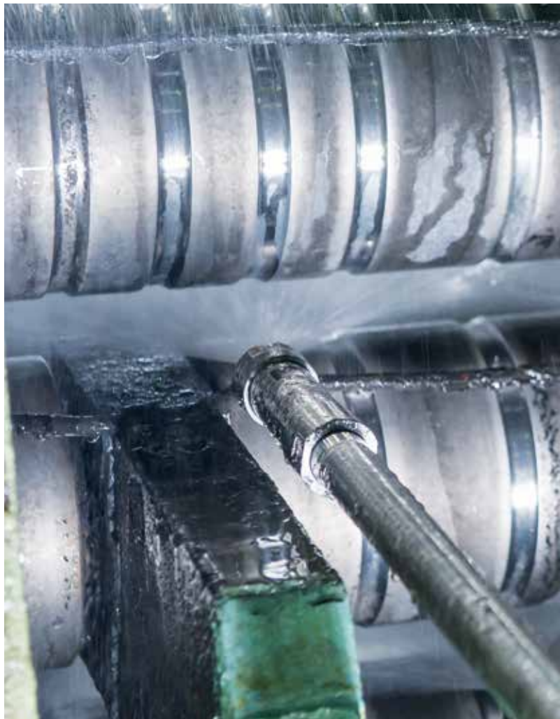
图3: DynaJet Flex喷嘴正在运行中。这是韩国现代钢铁公司唐津厂安装的系统。
