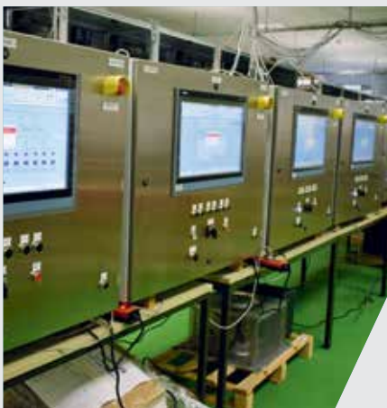
测试中心的作用是在新自动化设备发往钢厂之前对其进行测试。这些是精轧机换辊操作控制面板。
