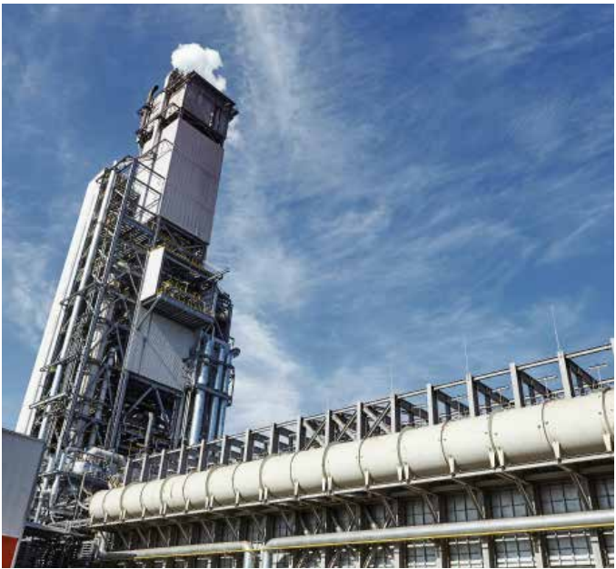
ЛГОК - Установка ГБЖ MIDREX № 3
