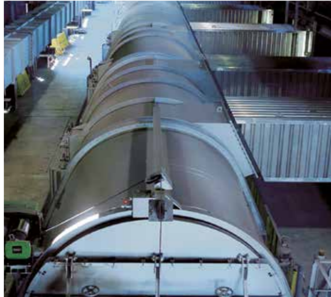
Waste-gas recirculation hood
