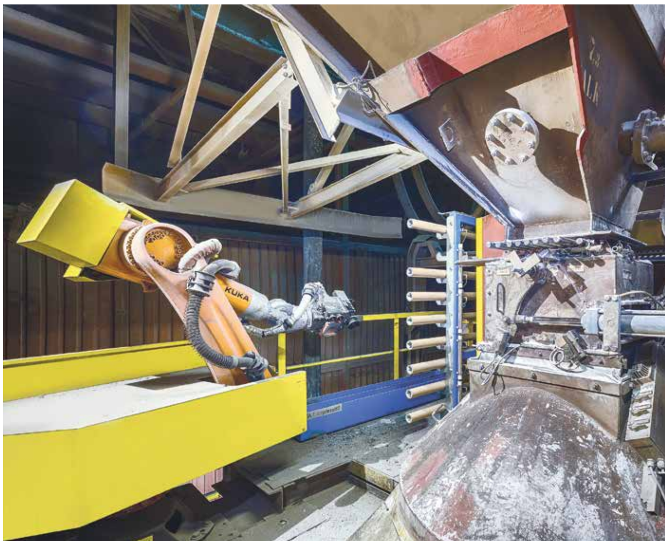
全自动操作转炉副枪探头的机器人系统(奥钢联钢铁公司, 奥地利林茨)
