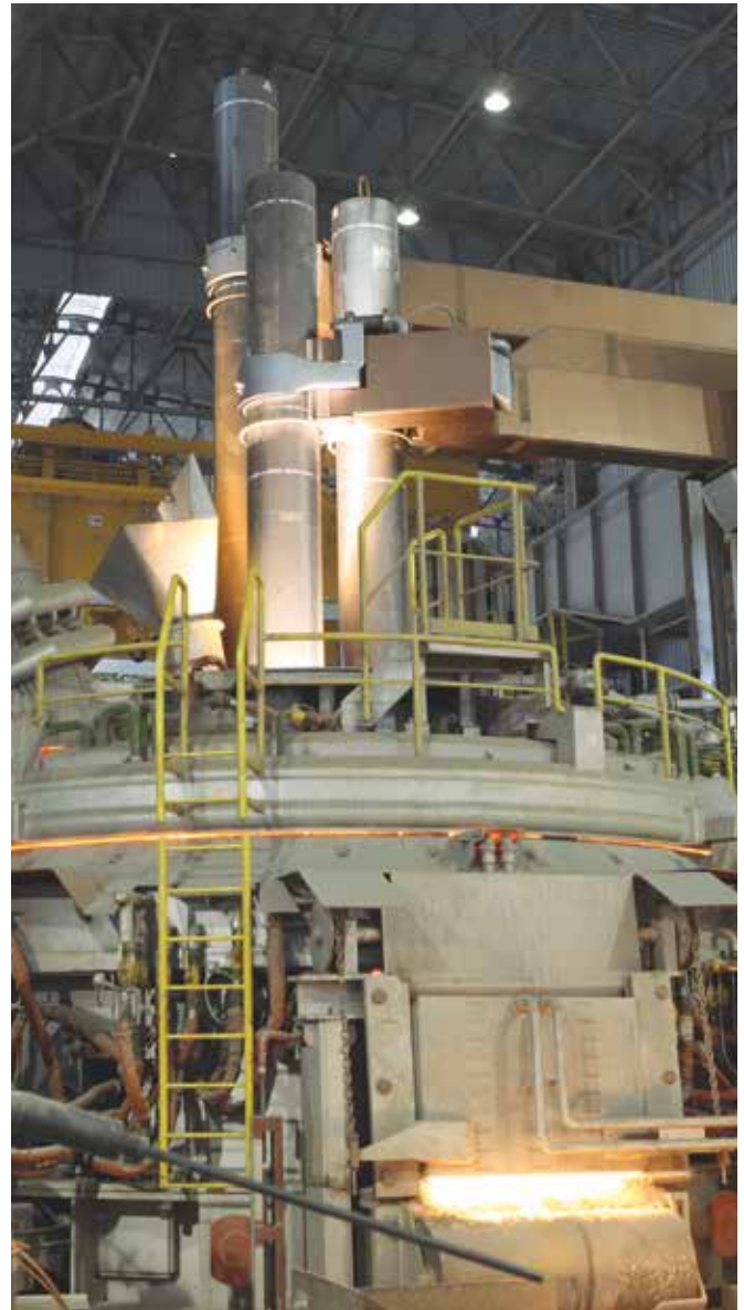
普锐特冶金技术为卡塔尔钢铁公司(卡塔尔Mesaieed工业城)建造的100吨FAST DRI电弧炉
