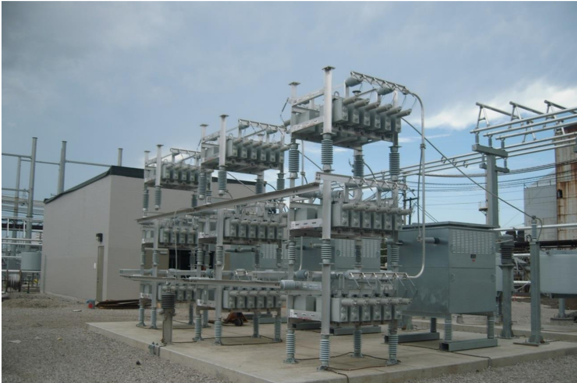
建设中的配备 SVC 系统的变电站
