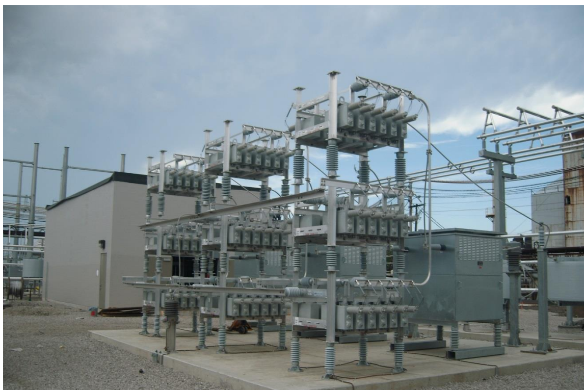
Subestação com o sistema SVC em uma construção à esquerda
