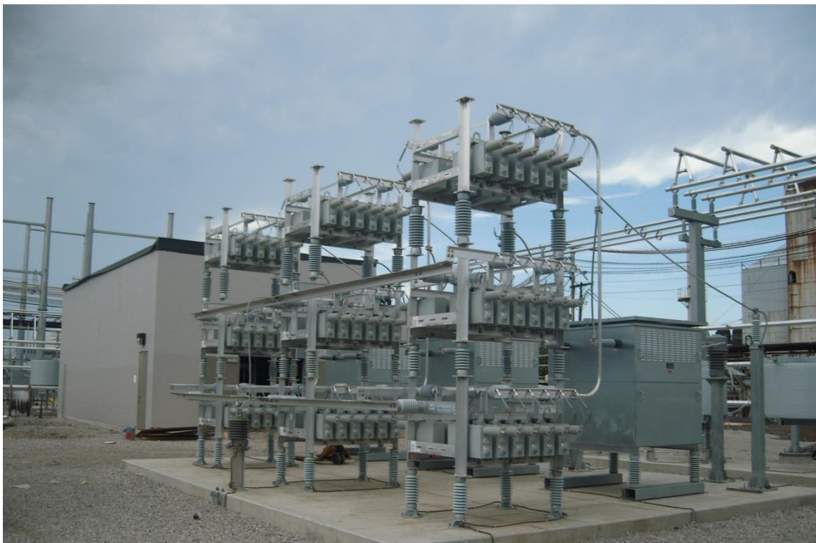
左の建屋内に SVC システムを装備した変電所
