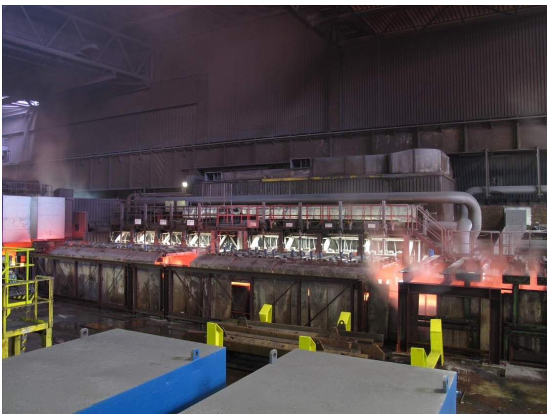
运行中的强力冷却设备
