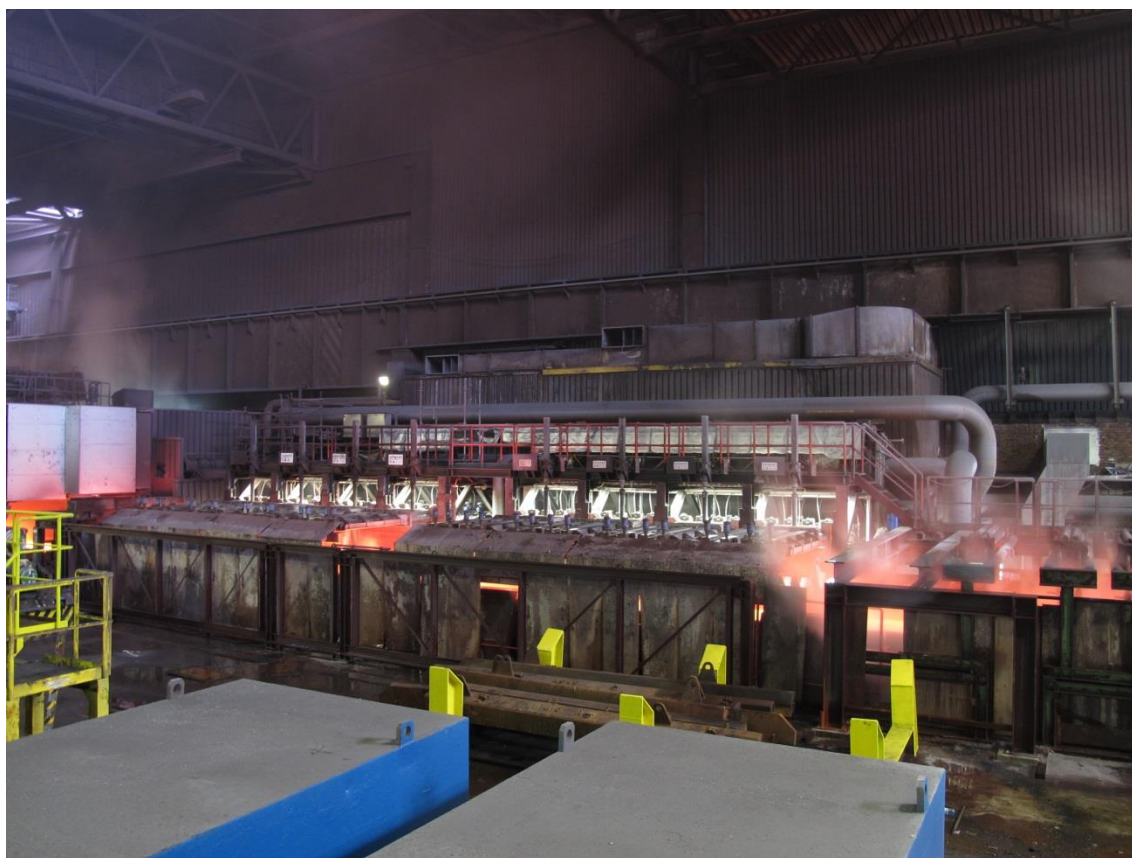
稼動中のパワー冷却設備
