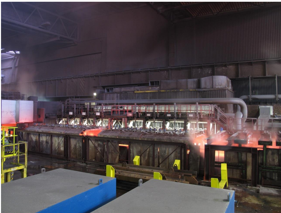
Линия интенсивного охлаждения в эксплуатации
