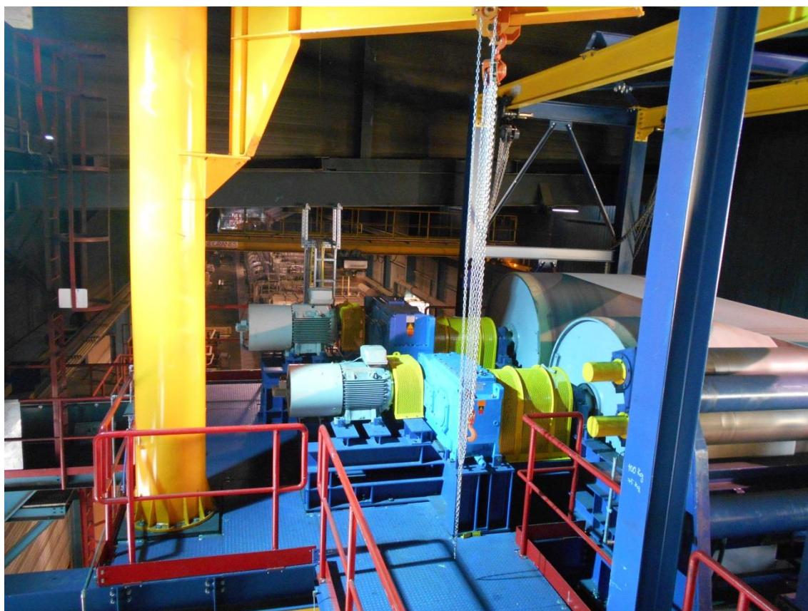
Modernisierter S-Rollen-Bereich der Glüh- und Beizlinie von Aperam im belgischen Genk, nach der Modernisierung durch Primetals Technologies
