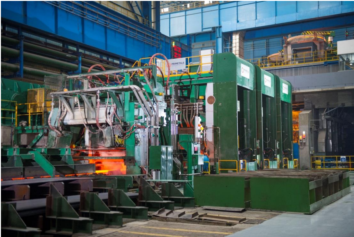
Linha ESP Numero 2 da Primetals Technologies em operação na Rizhao Steel
