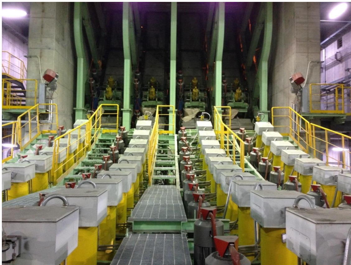
Máquina de lingotamento contínuo de blocos da Primetals Technologies na Hyundai Steel em Dangjin, Coréia do Sul.
