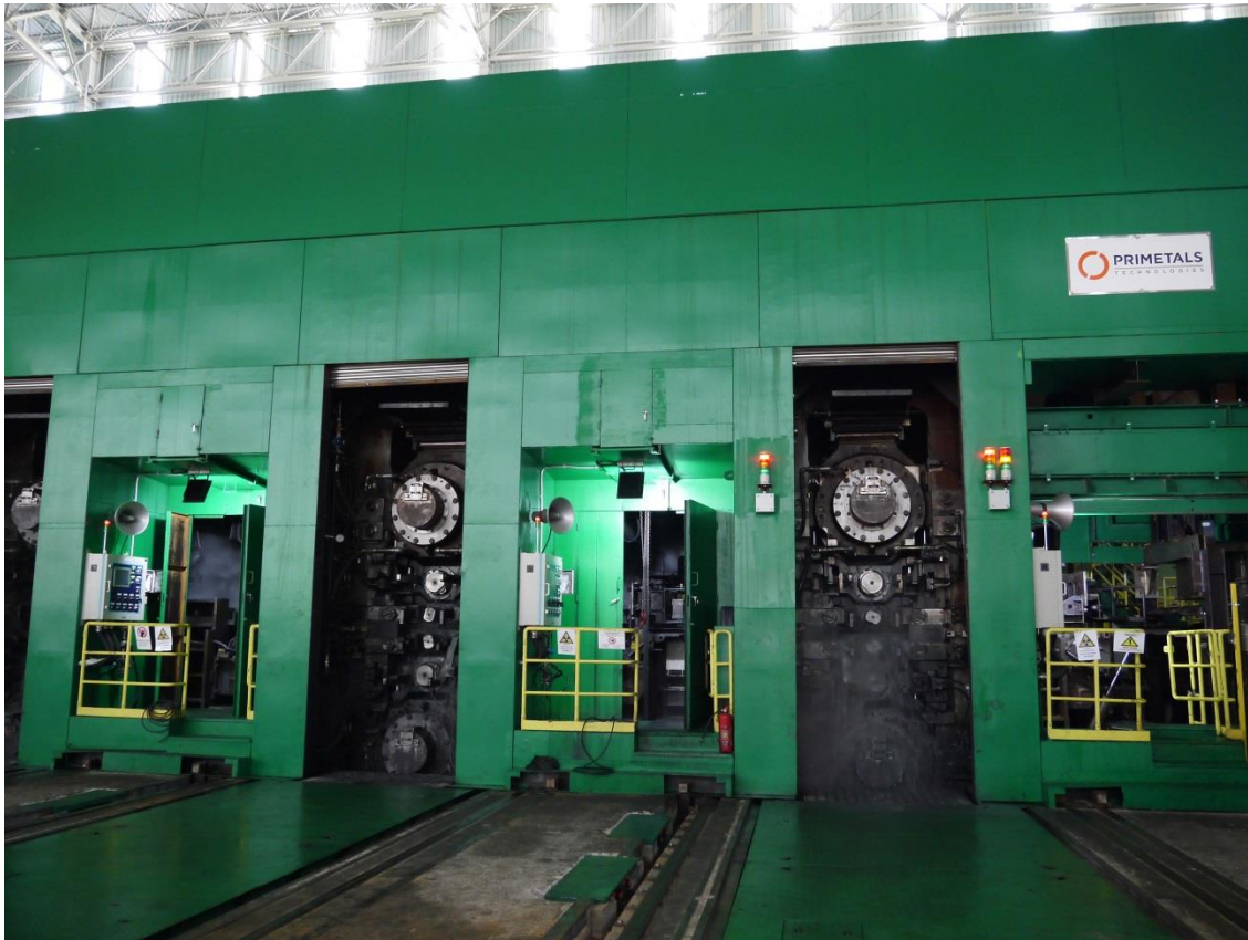
Sexto-UCM-Walzgerüst (Universal Crown Control Mill) von Primetals Technologies im Anlagenkomplex von Tosalı-Toyo Celik A.Ş. in Osmaniye, Türkei.
