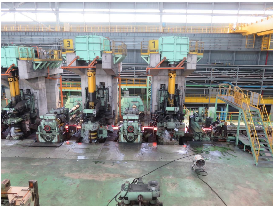
Kleines Stab- und Drahtwalzwerk von Primetals Technologies bei Hyundai Steel in Dangjin, Korea
