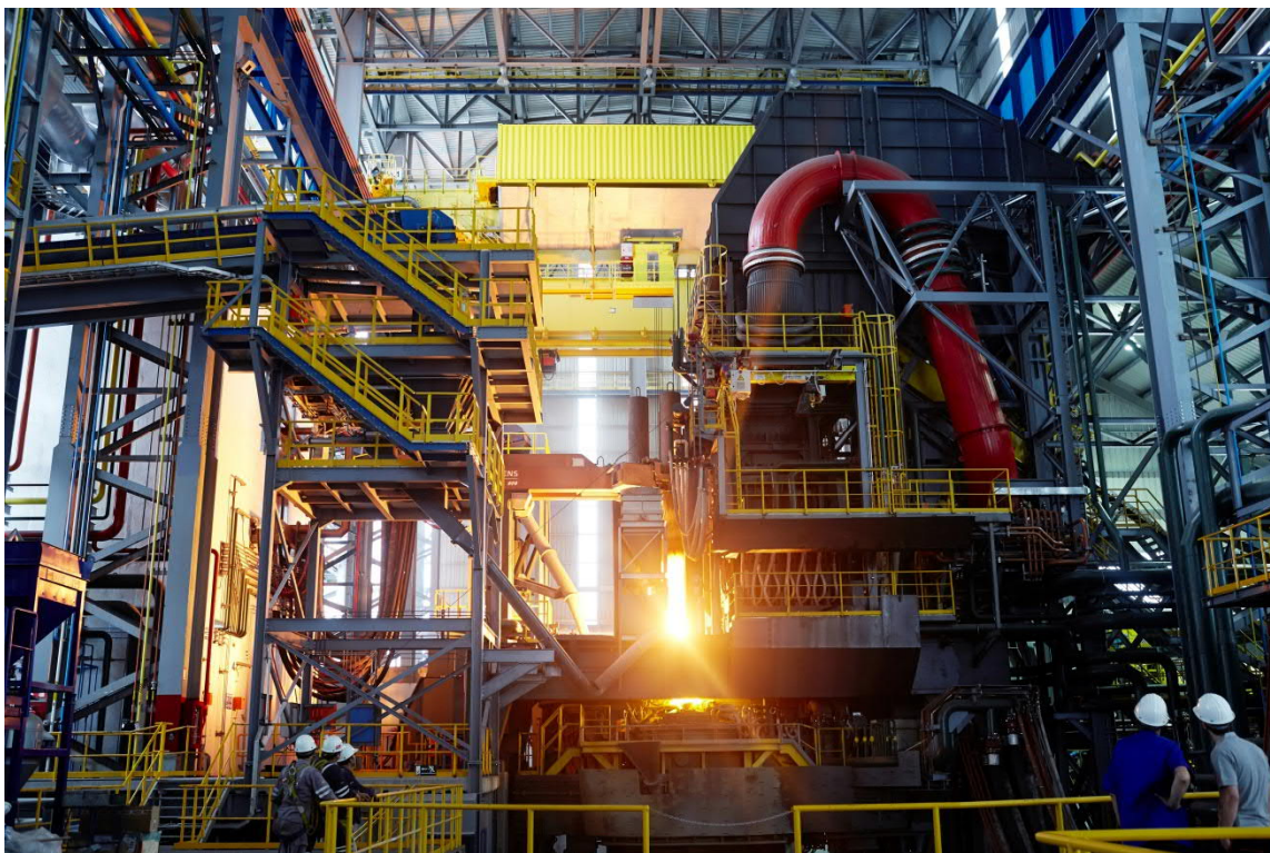
Forno elétrico a arco Quantum da Primetals Technologies
