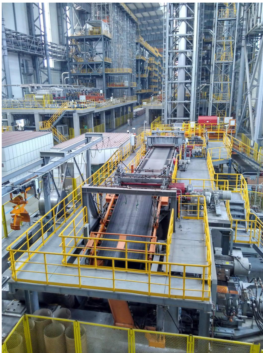
プライメタルズテクノロジーズ製の連続垂鉛めっきライン（CGL）
