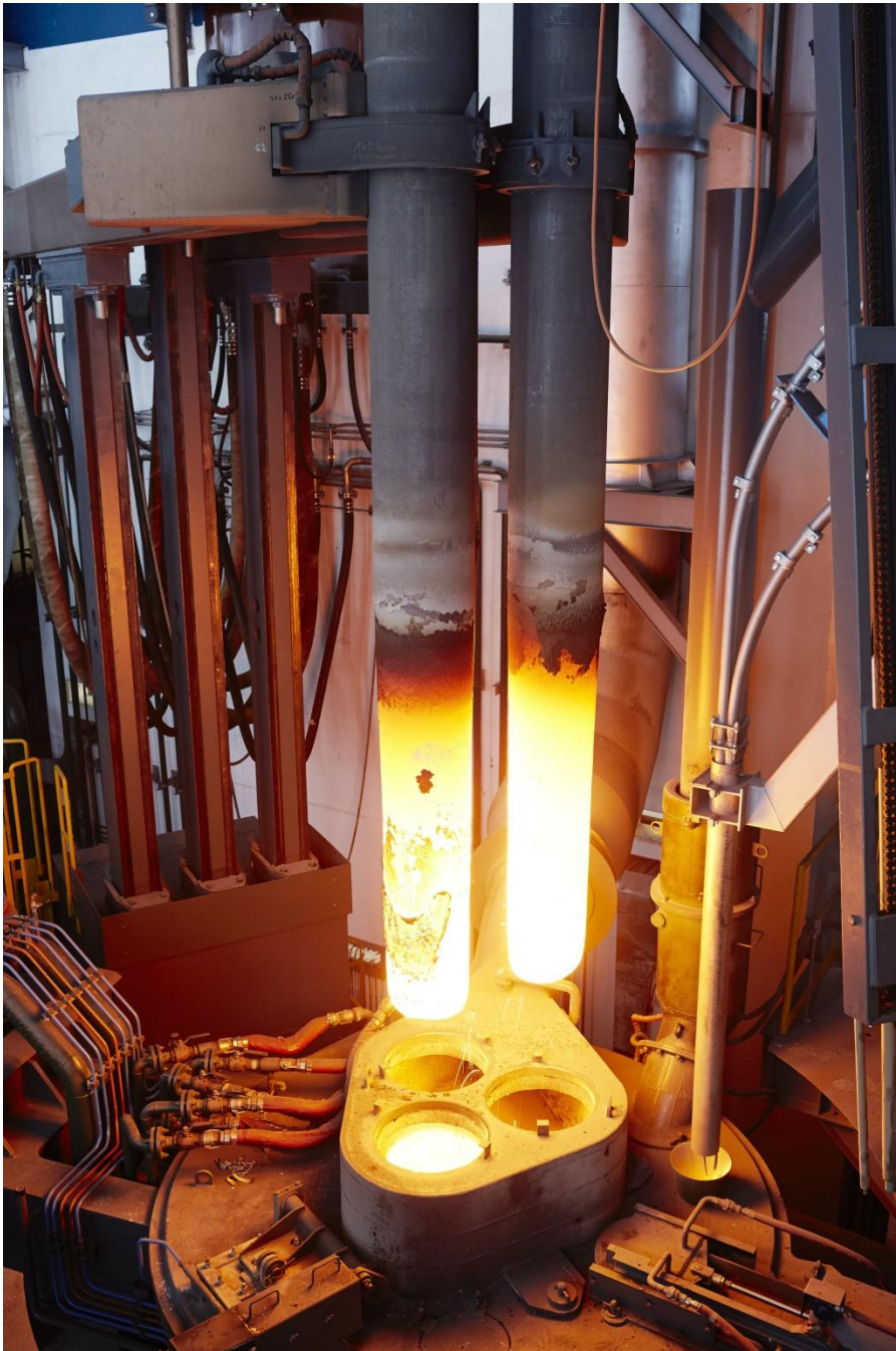
プライメタルズテクノロジーズのレードルヒーティングステーション。
