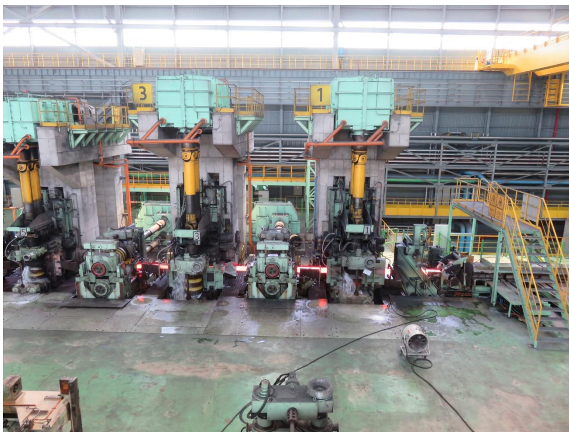
Мелкосортный стан компании Primetals Technologies, установленный на Hyundai Steel в г. Танджин, Южная Корея
