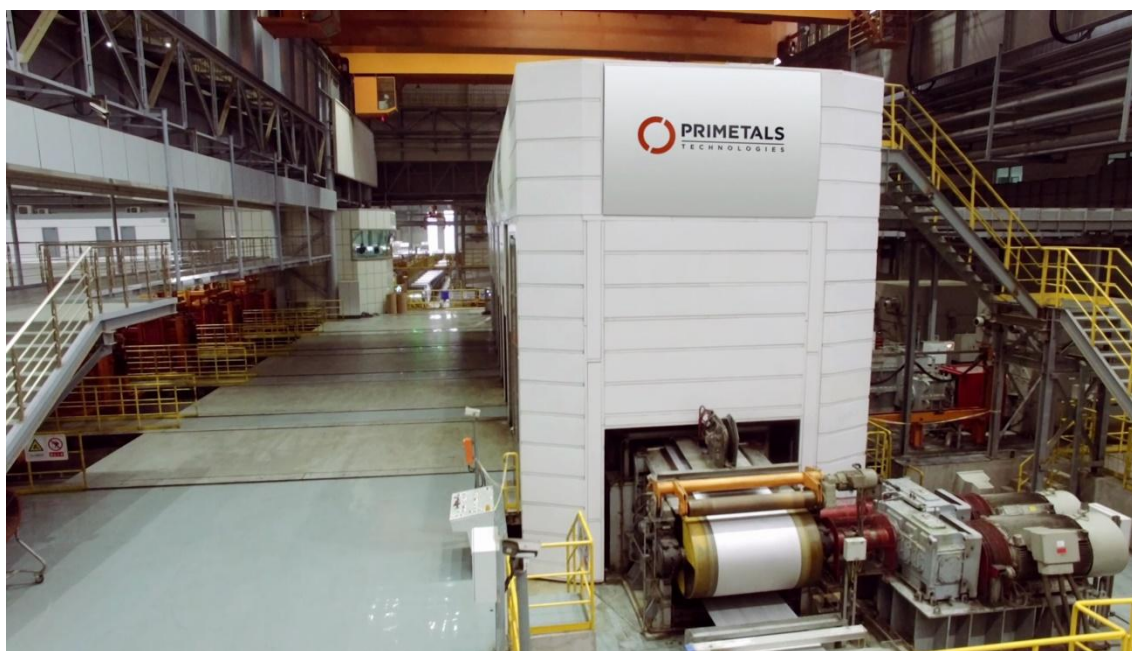
Kaltwalzwerk von Primetals Technologies bei der Tangshan Iron and Steel Group Co. Ltd.
