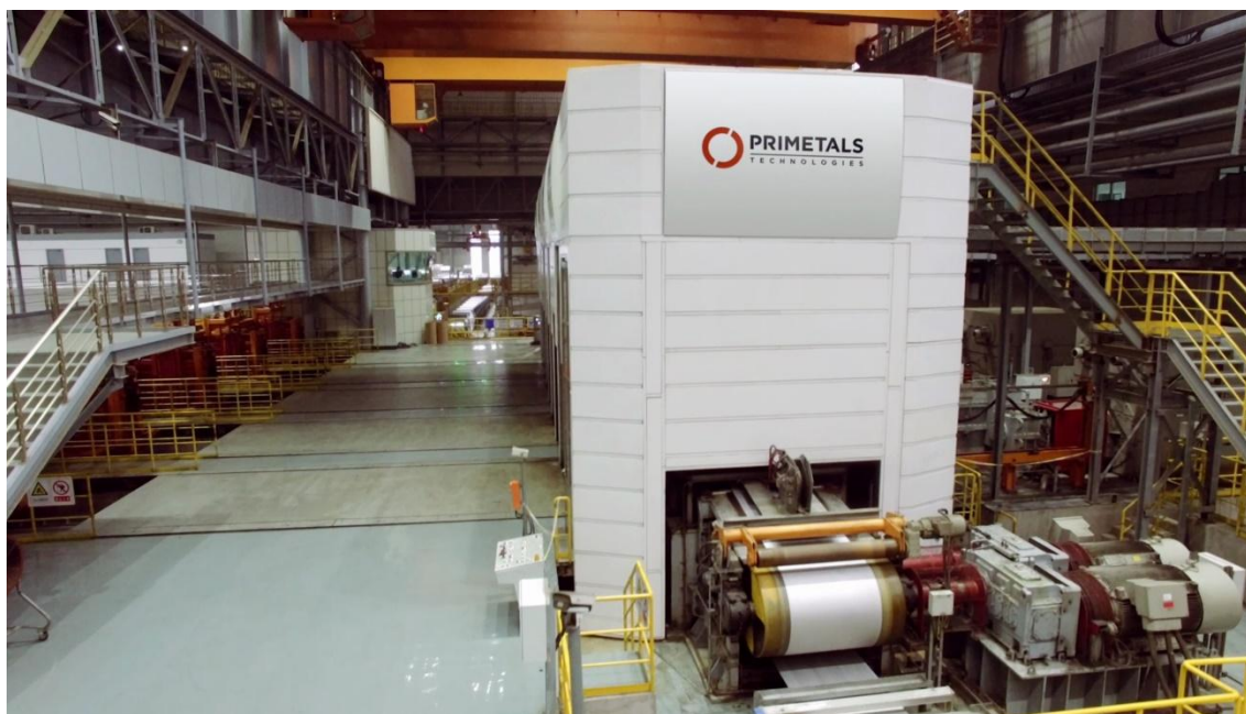
Laminador a frio da Primetals Technologies na Tangshan Iron and Steel Group Co. Ltd.
