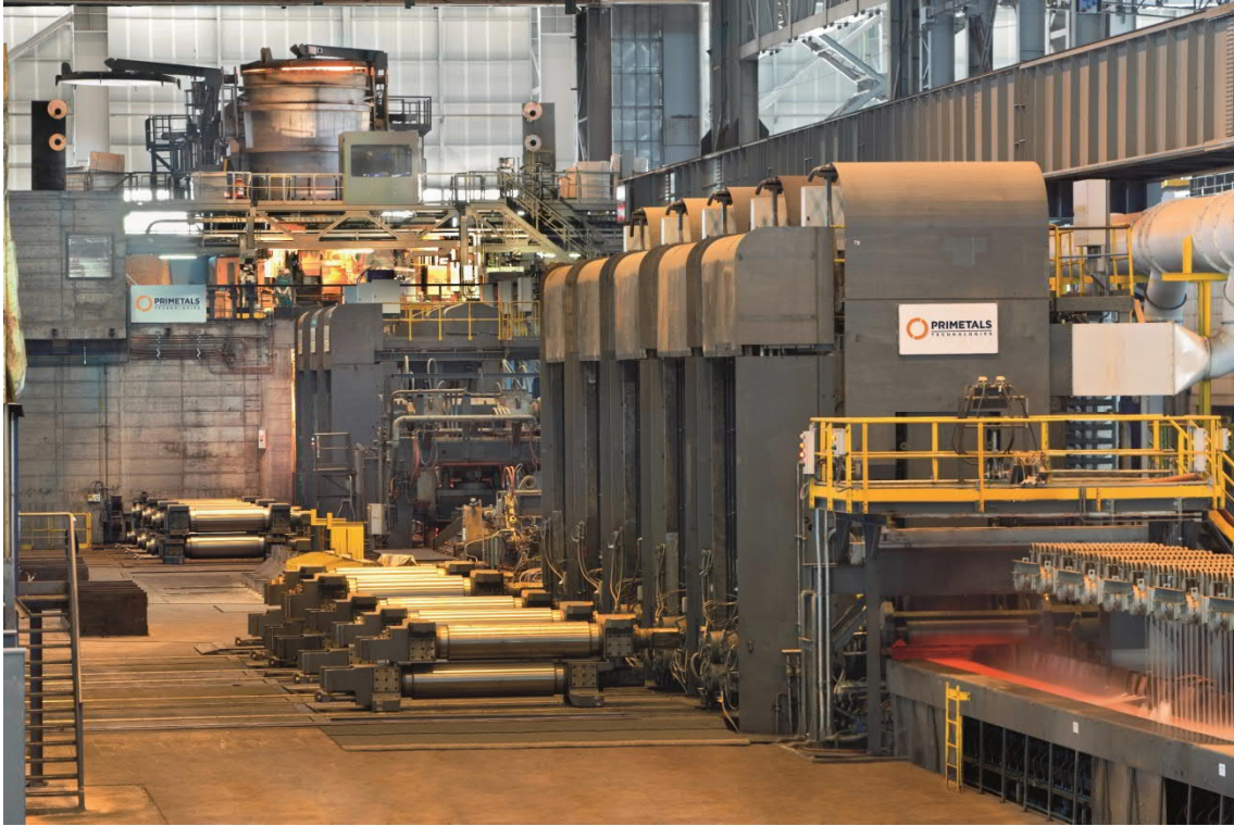
操業中の Arvedi ESP プラント（他社の設置事例）
