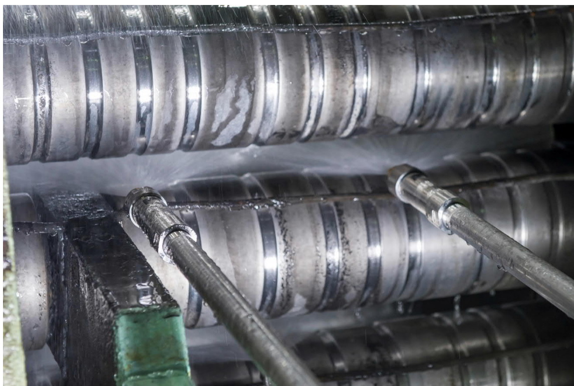
冷却帯に設置されたプライメタルズテクノロジー製のパルス幅可変冷却システム 「ダイナジェットフレックス」
