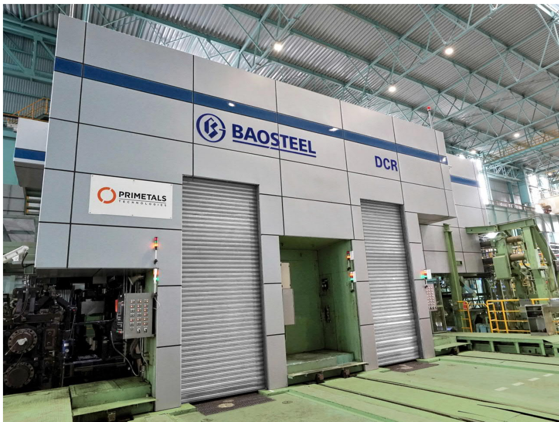
プライメタルズテクノロジーズが宝鋼に納入した新 DCR ミルの前面
