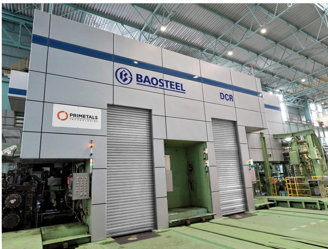
Фотография нового DCR-стана, поставленного Primetals Technologies на производственную площадку компании Baosteel
