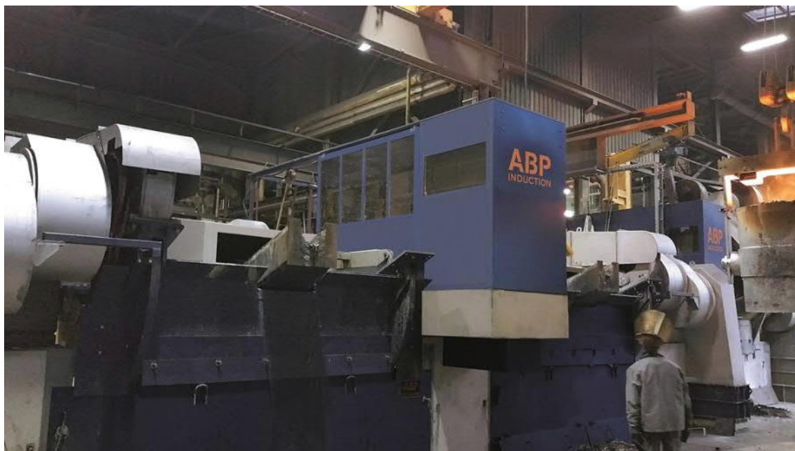
Forno IFM 7 Twin Power da ABP, com capacidade de 13,4 toneladas e potência nominal de 6MW (Foto: cortesia da ABP)
