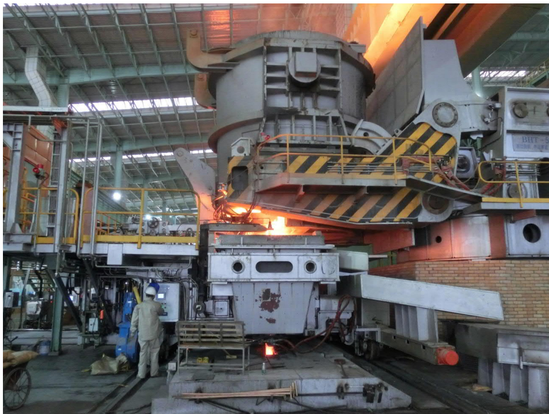
宝鋼湛江鋼鉄にて稼働中のプライメタルズテクノロジーズ製 2 ストランド式スラブ連続鋳造機
