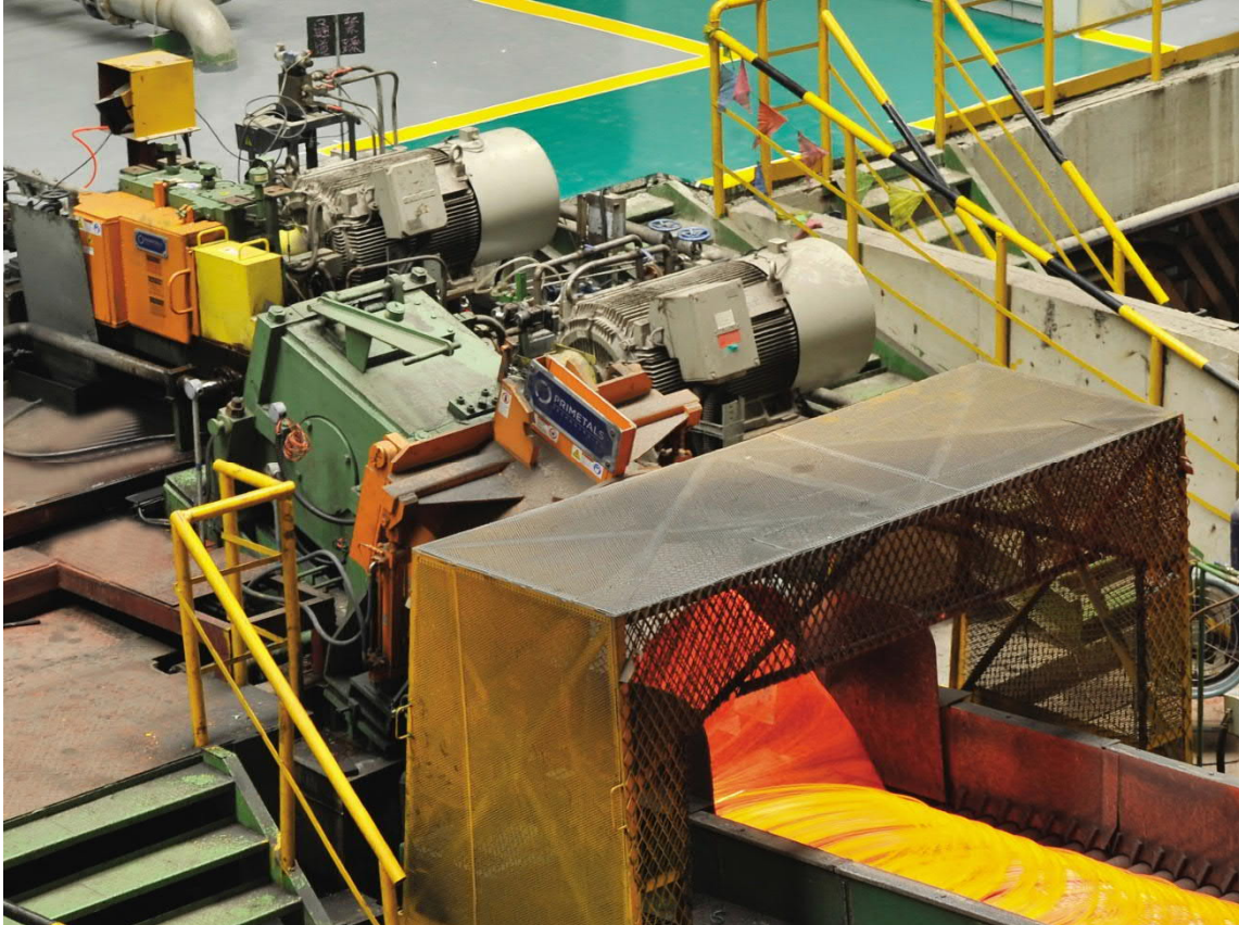
一条线材线上安装的摩根高速吐丝机和摩根 Stelmor 冷却运输线。
