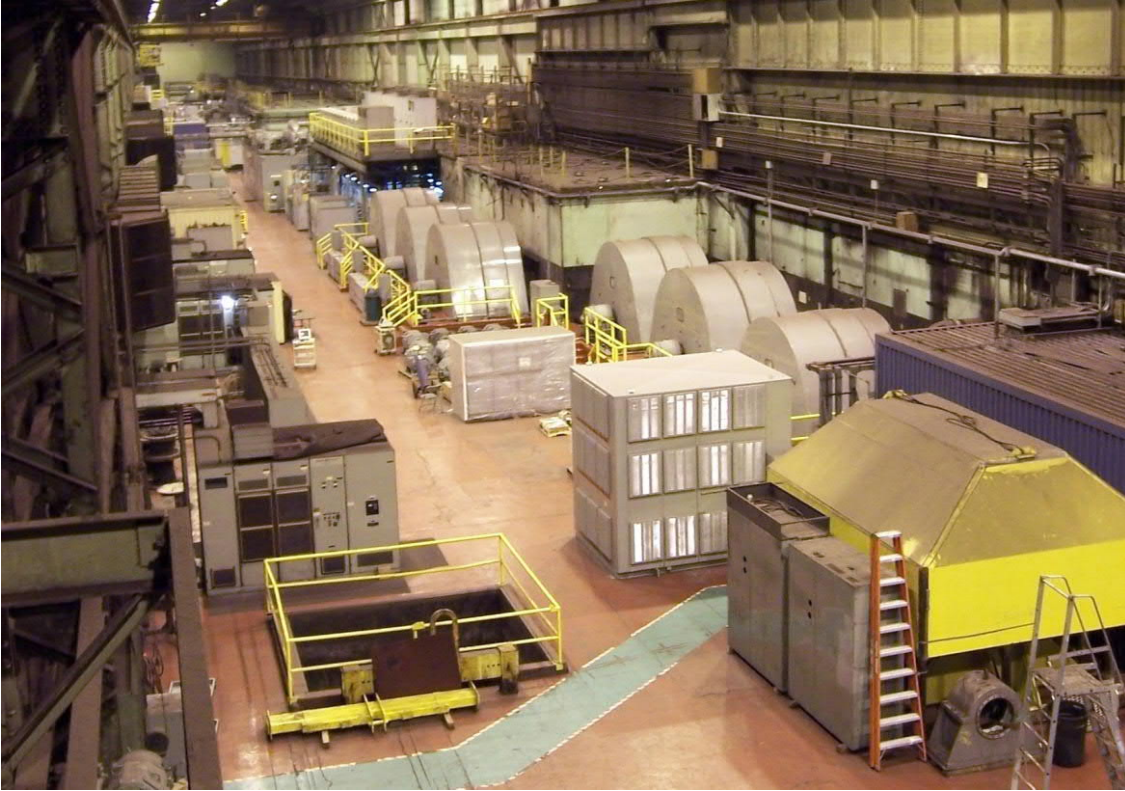
加利福尼亚钢铁工业公司加利福尼亚州 Fontana 厂的精轧机电机室(照片由 CSI 提供)
