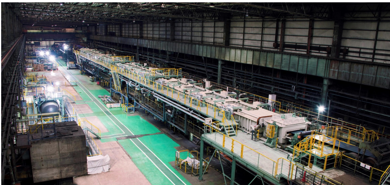
ポリプロピレン樹脂製 PP-iBox 酸洗設備／設備更新後（2020 年 7 月 13 日撮影）
