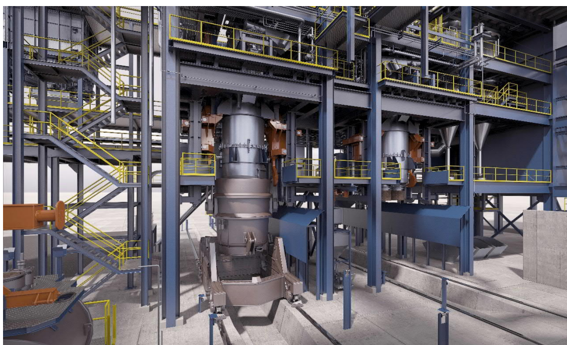
配备 CVL 提升系统的普锐特冶金技术双工位 RH 脱气设备
