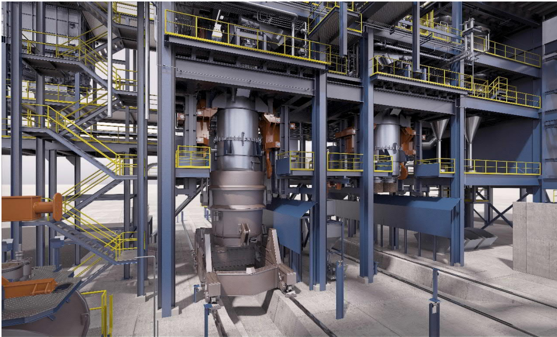
Doppel-RH-Entgasungsanlage mit CVL-Hebesystem von Primetals Technologies
