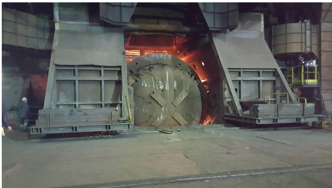
アルセロールミittal ゼニカの更新予定の転炉 2 号機
