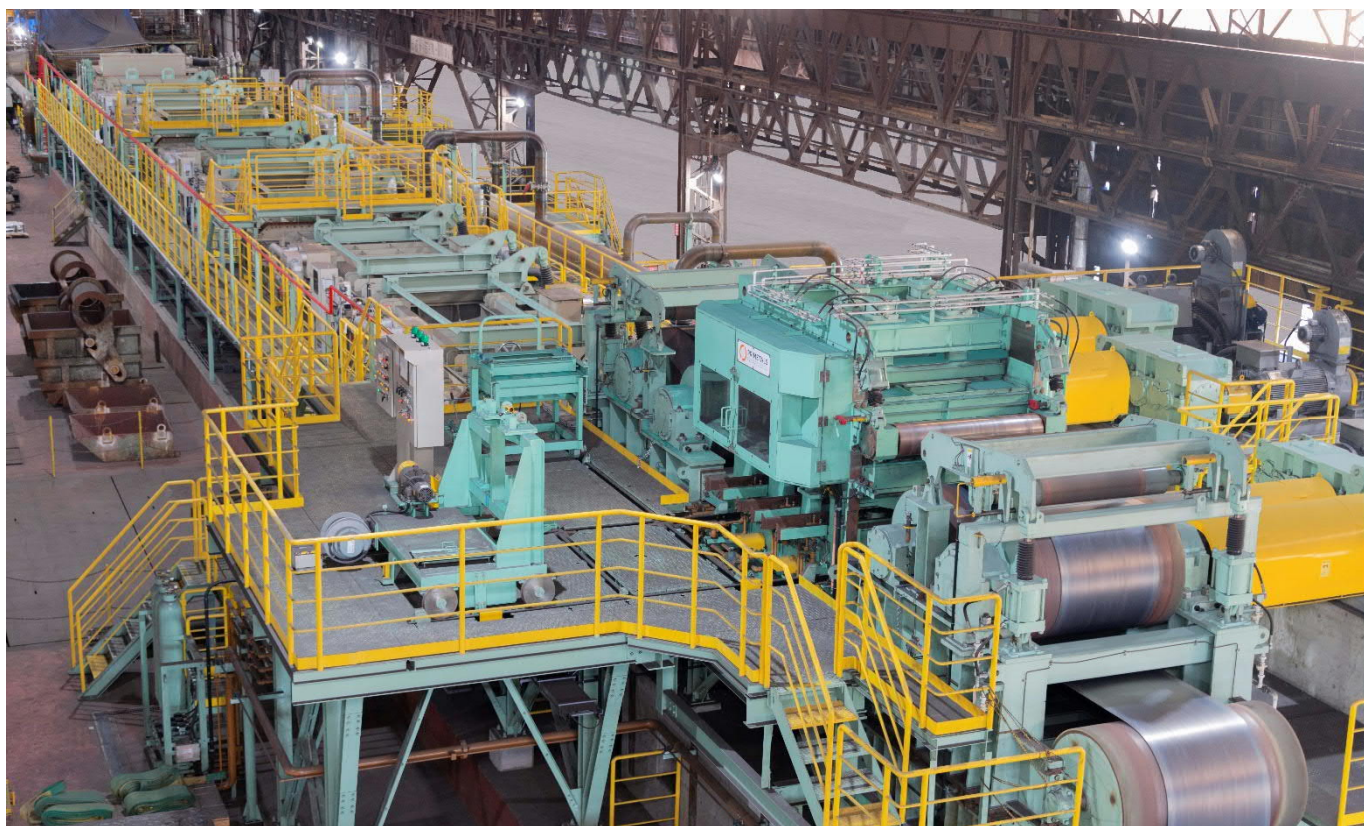
东京钢铁有限公司冈山厂安装的聚丙烯 iBox。
