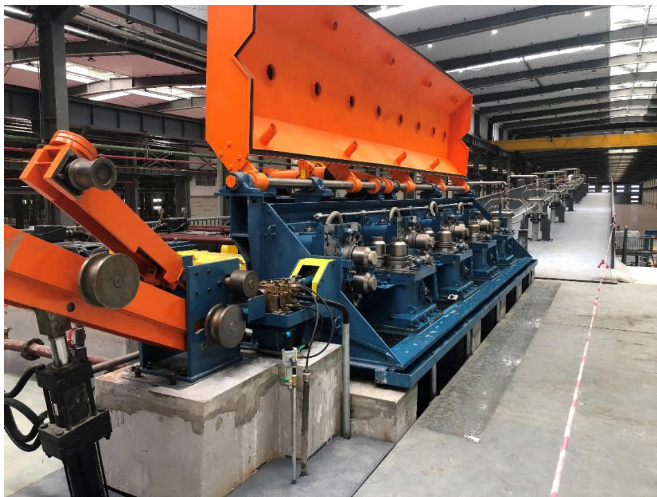
プライメタルズ テクノロジーズ製 銅棒圧延機
