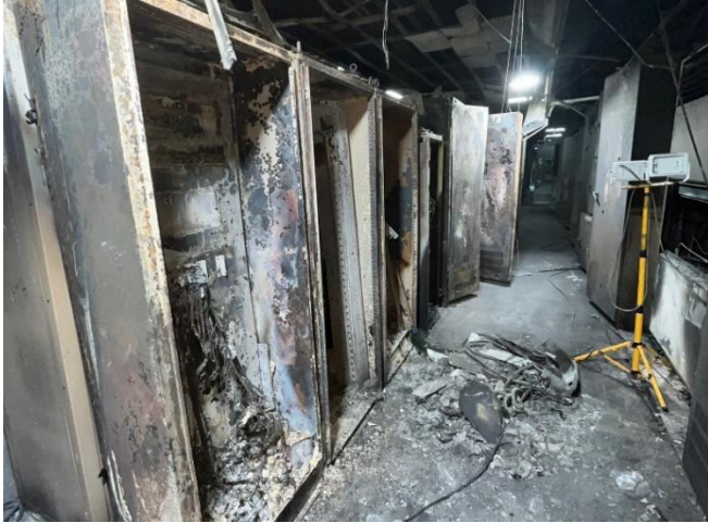
火災により大型線材圧延工場の電気室の全設備が損傷
